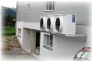
Kondensatoren in Verbindung mit Wärmerückgewinnung
