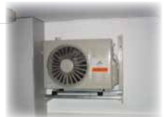
Einzelraum Split Klimaanlage für Serverräume 365-Tag-Betrieb
