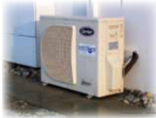
Einzelraum Split Klimaanlage Ausseneinheiten
