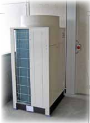
Mehrraum Split Klimaanlage Ausseneinheiten
